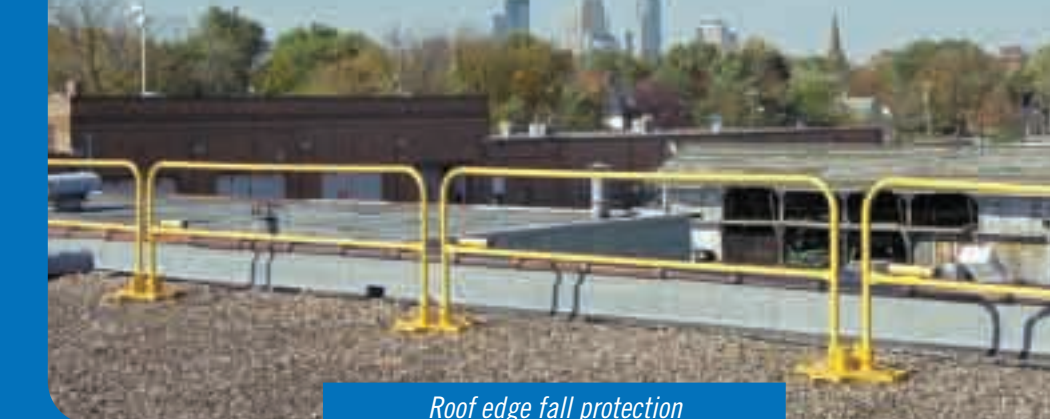
Roof edge fall protection
